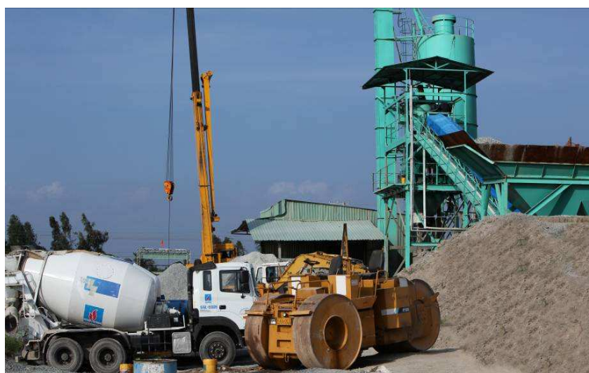
Trạm trộn bê tông tại Ấp Tắc Thủy, xã Hồ Thị Kỷ, huyện Thới Bình, tỉnh Cà Mau
